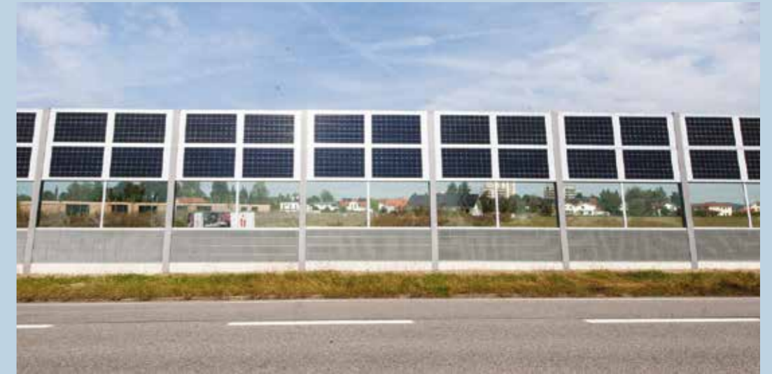
Εγκατάσταση Φ/Β σε φράγμα θορύβου στο Neuötting, Γερμανία © Quelle: R. Kohlhauer GmbH
